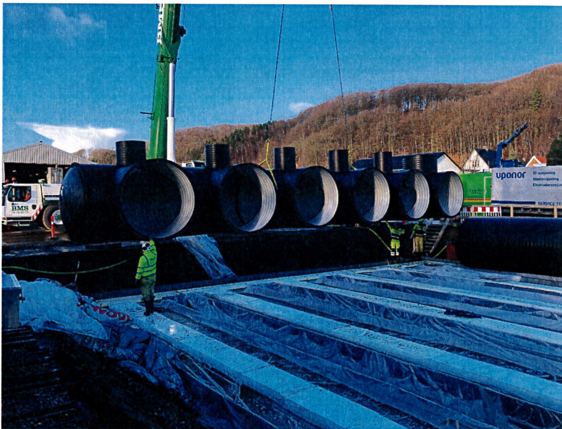
Rørbassin ved Vestbanevej
