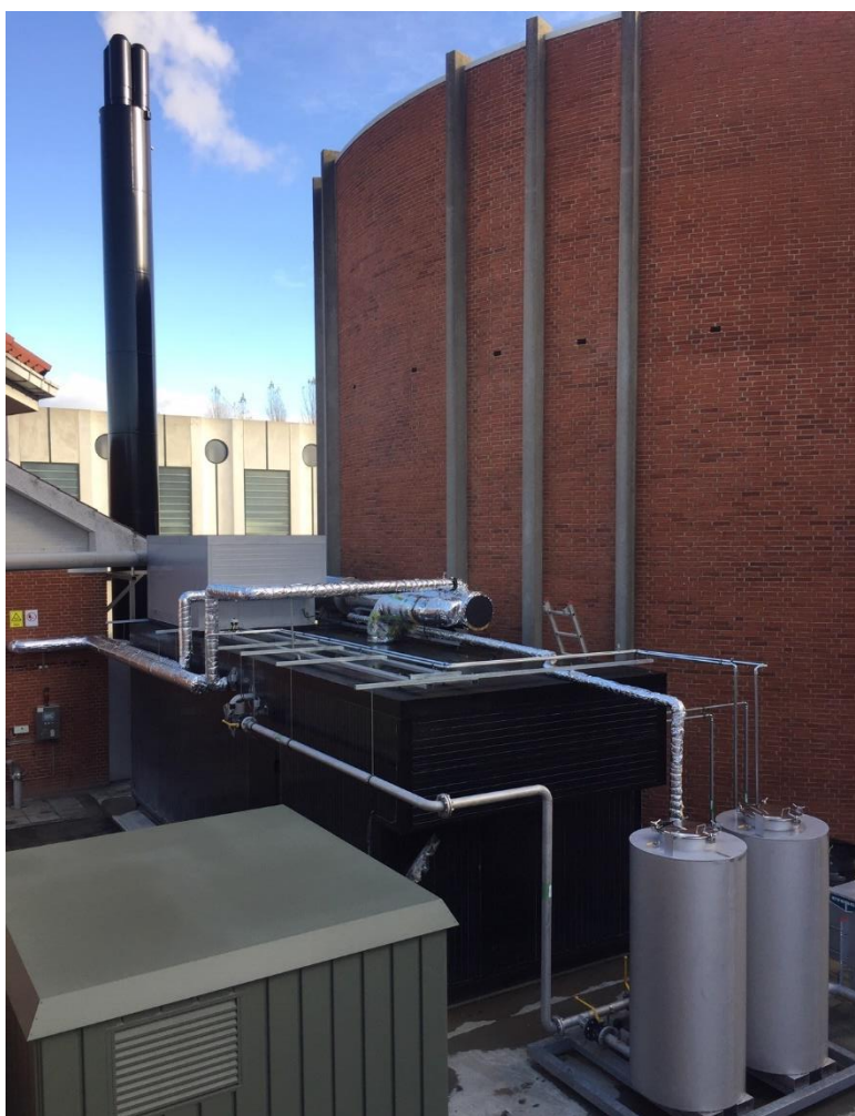
Den nye gasmotor på Vejle Centralrenseanlæg
