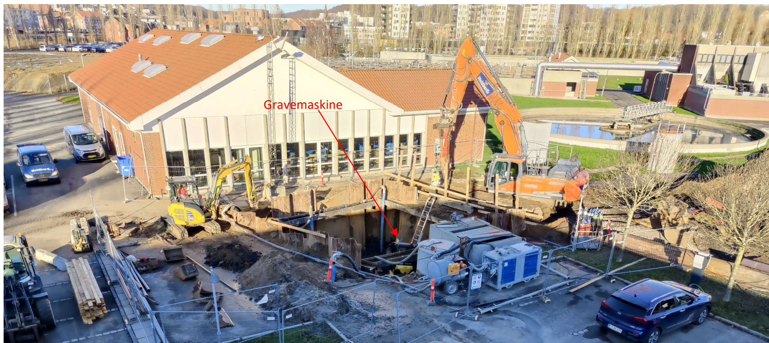
Nyt indløbsbygværk på Vejle Renseanlæg
